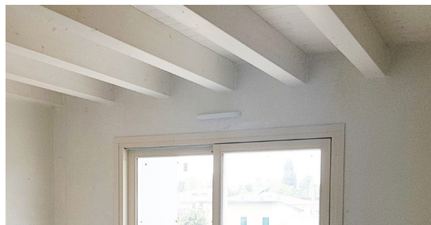
Foto 2 - Bocchetta interna per immisione dell'aria in soggiorni e camere da letto
